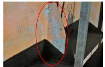
鉄骨張側面の取り残し
