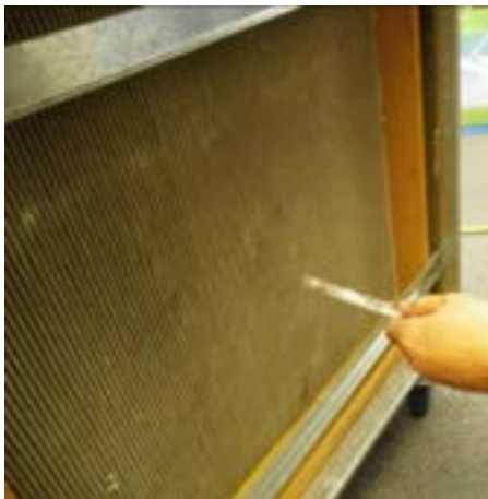
参考図3.24 HEPAフィルター面
