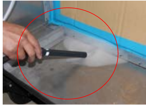
HEPA フィルタ取り付け面の隙間から煙が吸い込まれていく
