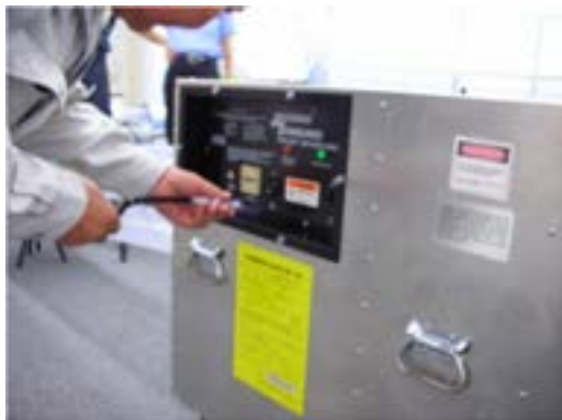
参考図3.29 コントロールパネルの接合部スイッチ等の取り付け部
