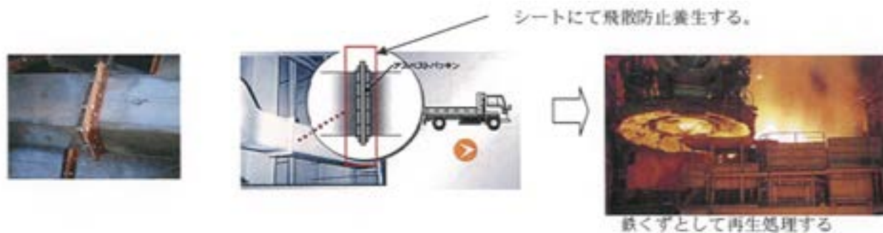
図4.10.5 配管やダクトのジョイント部分の石綿含有パッキンをそのまま処分する例
