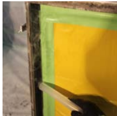
参考図3.25 HEPAフィルター周辺部分
