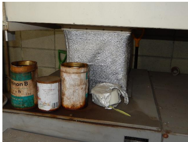
たわみ継手アルミ箔貼り（石綿布）
