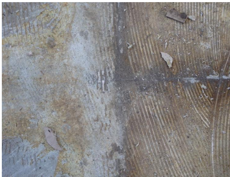
図 2.39 石綿含有接着剤
