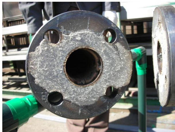
劣化して固着しているガスケット
