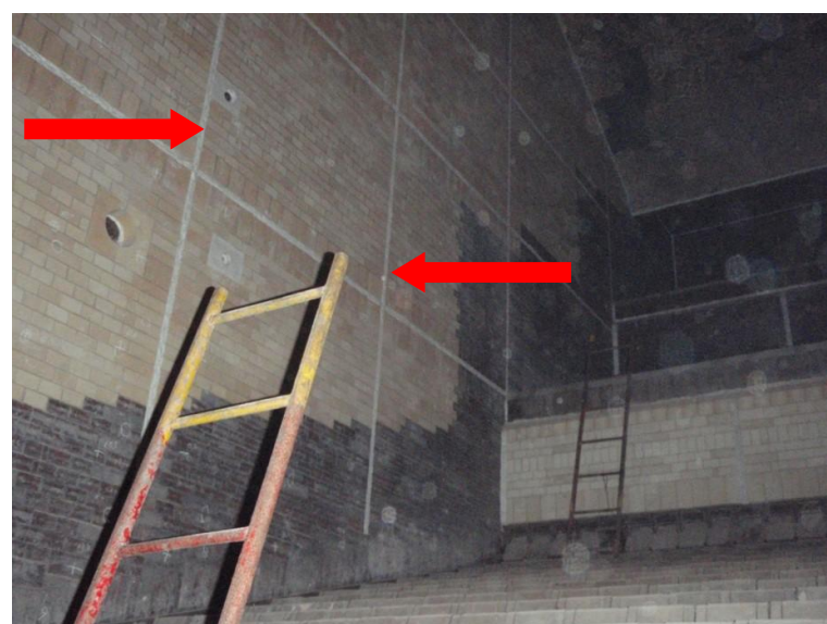
図 2.49 燃焼室の炉内側の耐火レンガと熱膨張しろエキスパンション（赤矢印の部分）
