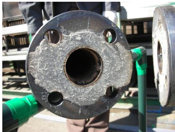
劣化して固着しているガスケット
