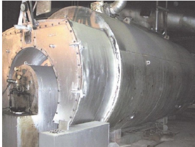
10 図 2.22 ボイラーに施工された保温材
