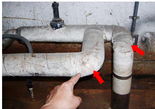
配管エルボを覆う石綿含有保温材
