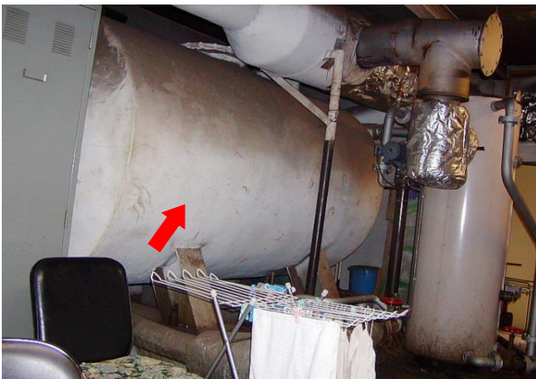
ボイラー本体を覆う石綿含有保温材
