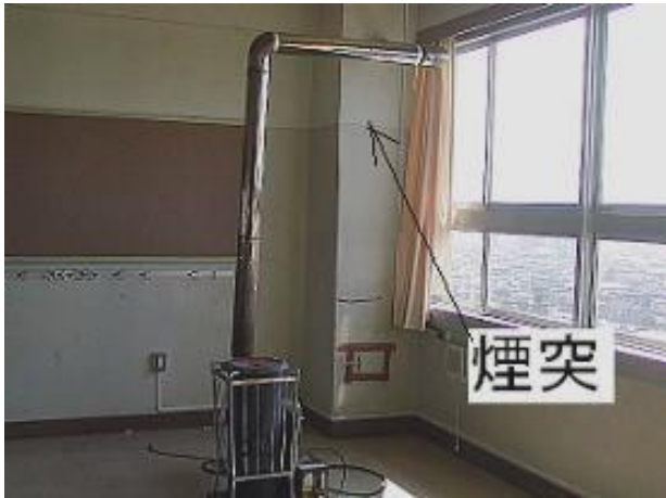
石綿セメント円筒（煙突としての利用）
