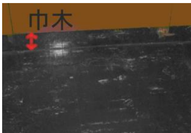
石綿含有ソフト巾木（ビニル床タイルと同材質の場合が多い）
