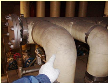
配管エルボ部分の石綿保温材 外観
