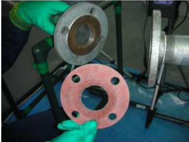
劣化していないガスケット
