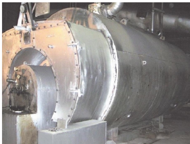
図 2.30 ボイラーに施工された保温材
