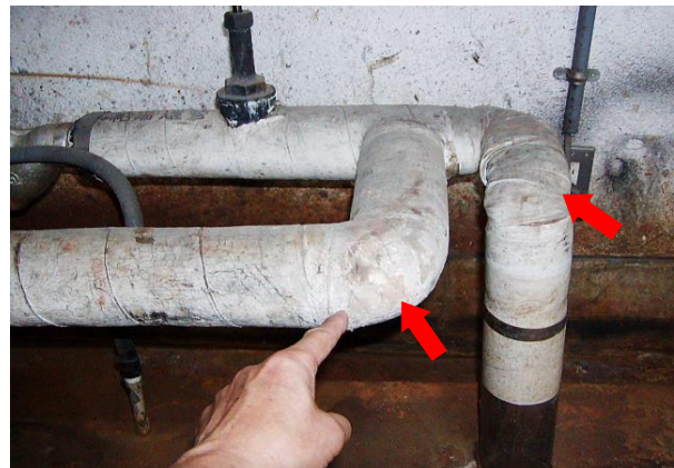
配管エルボを覆う石綿含有保温材
