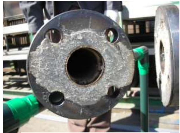
劣化して固着しているガスケット
