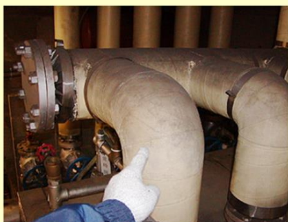
配管エルボ部分の石綿保温材 外観
