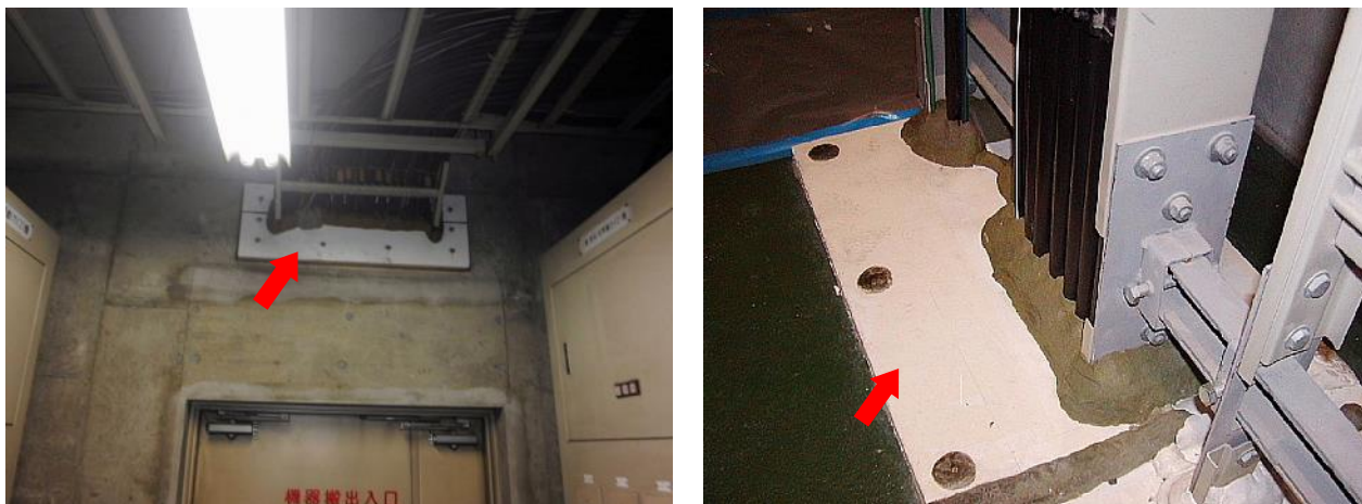
図 2.25 壁や床のケーブル貫通部の処理（けい酸カルシウム板第2種）
