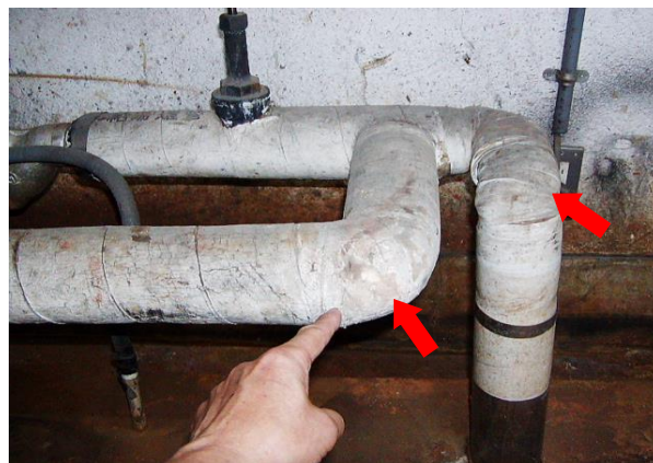
配管エルボを覆う石綿含有保温材
