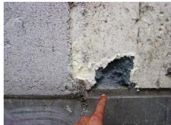
吹付け石綿（クロシドライト）にクリソタイルの2層吹き（旧工事）、この上に石綿不含有の吹付けロックウール
