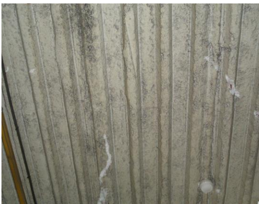
(やや劣化) 引っ掻き傷ではなく、原因不明の素材の筋状の色違いが生じている。
