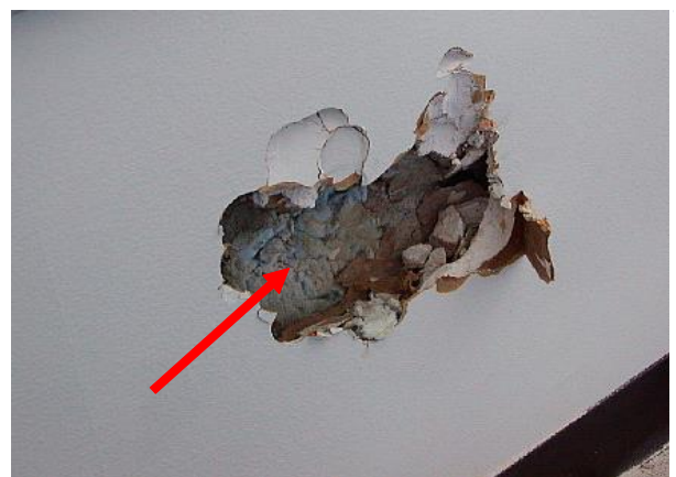
上図矢印位置の腰壁を破壊開放。ウレタン吹付けあり(不採取)
