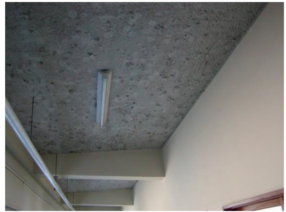
(劣化) 多くのスパンで損傷があり、一部では界面にまで達する傷が多くある。
