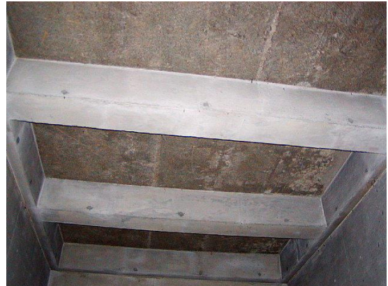
(やや劣化) 天井。下地の目地が浮き出ている。漏水の痕跡が変色している。
