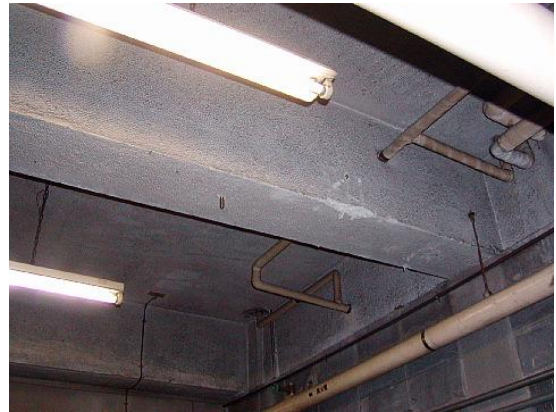
(やや劣化) はり 何かぶつけた痕があり、その部分が脱落し、下地まで達している。その他箇所にも類似の傷がある。
