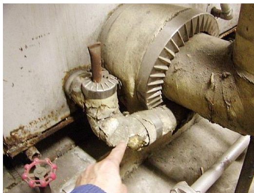
⑯ 機械室A・B共に配管エルボ部の損傷は顕著なものも複数ある
