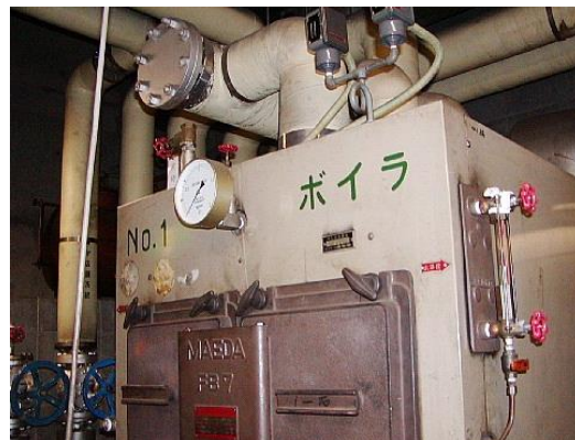
⑩ 1号ボイラー(ボイラー本体内部の断熱材は使用中のため未確認)
