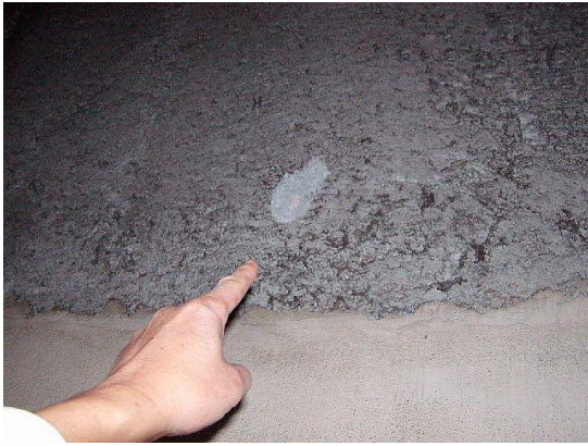
(やや劣化) 打傷の痕跡が他の部分も含めて複数箇所ある。
