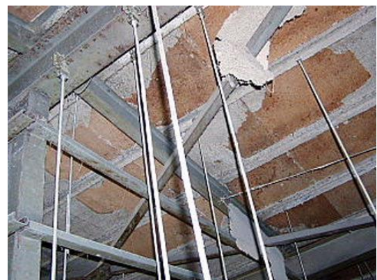
(劣化) 屋根野地板との付着力がないための脱落
