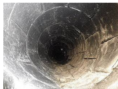
煙突断熱材「パールスタック」 頂部から撮影
