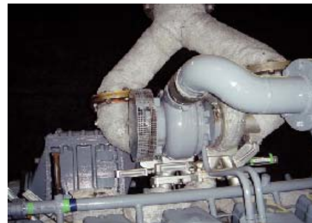
配管エルボの保温材②
