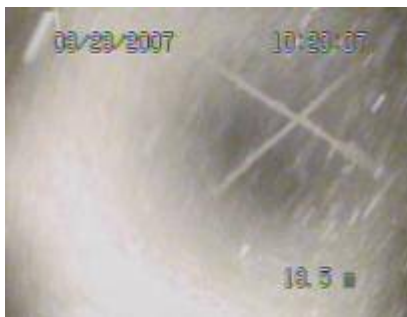
⑪暗視カメラ（障害物確認）
