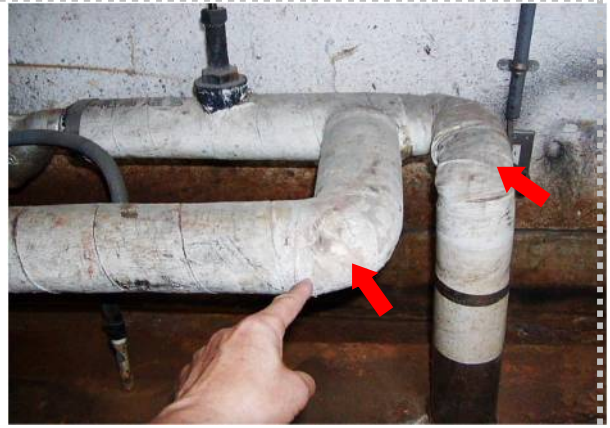
配管エルボを覆う石綿含有保温材
