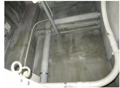
耐火二層管には石綿含有の可能性がある。比較的容易に発見が可能である
