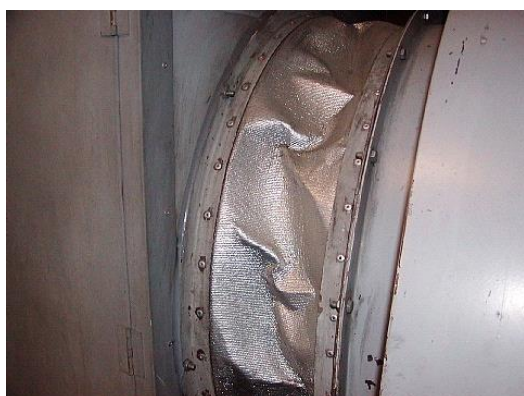
㉑ 空調ダクトの送風側に伸縮継ぎ手(不採取)
