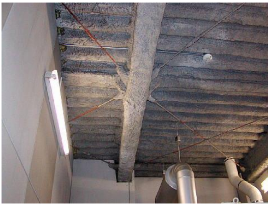
(やや劣化) 折板屋根に吹き付けされ、結露などによる色ムラが生じている。
