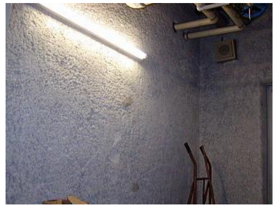
(やや劣化) 全体的な状態はよいが、人為的な損傷が多面にある。
