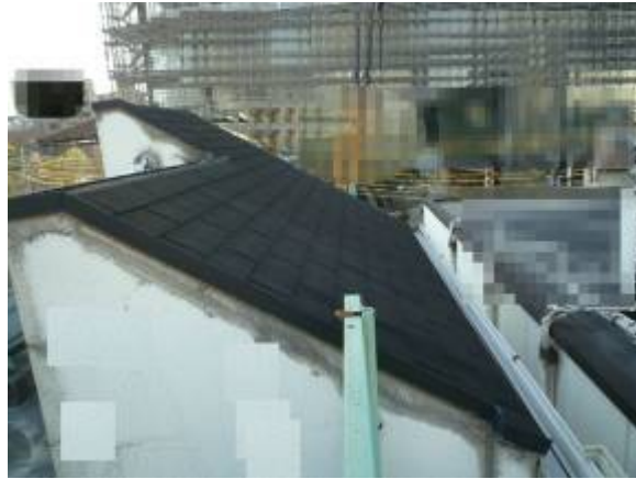
低層ビル屋上の階段室屋根の化粧スレート（アスベストコロニアル）
