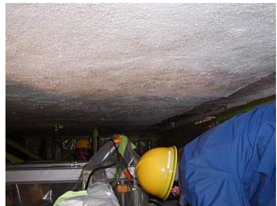
(やや劣化) ある特定のスパンだけ、広範囲に擦過傷がある。
