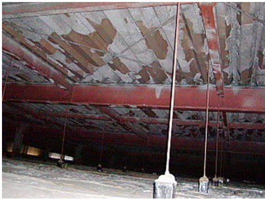
(劣化) 折板屋根。気温や風圧による折板屋根の収縮や振動での脱落
