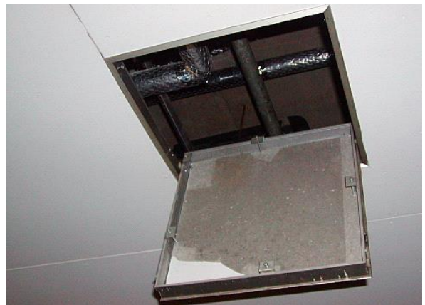
同左 点検口開放(矢印部)、石綿除去後に設備改修され、その配管を隠すために天井を貼ったものと思われる
