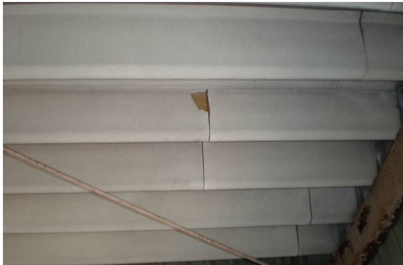
図 2.17 石綿含有炭酸カルシウム発泡断熱材
