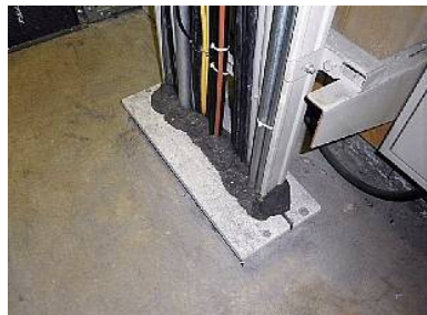
ケーブル貫通口。上下階や隣室などの開口部には耐火パテ、ケイ酸カルシウム板2種などの耐火板が使用される
