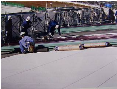
野地板（含有の疑義）およびルーフィングにも含有の可能性があるが調査不可能である
