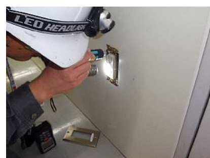
コンセントは壁の裏側が覗ける重要な場所であることに注目しておきたい
