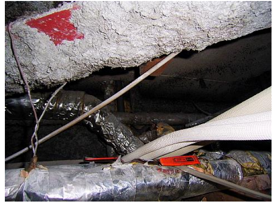
(劣化) 複数部分ではく落し、天井裏に散在・堆積している。
