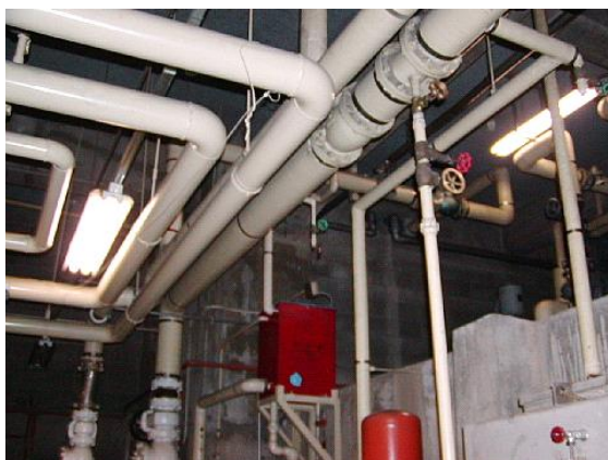
空調機械室。天井の一部(北側)に長さ1m程度の人為的な傷あり(設備改修工事?)
