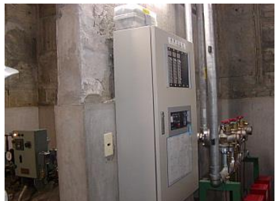
石綿除去工事が完了し、塗装されたが、分電盤の裏に吹付け石綿が取り残されている
