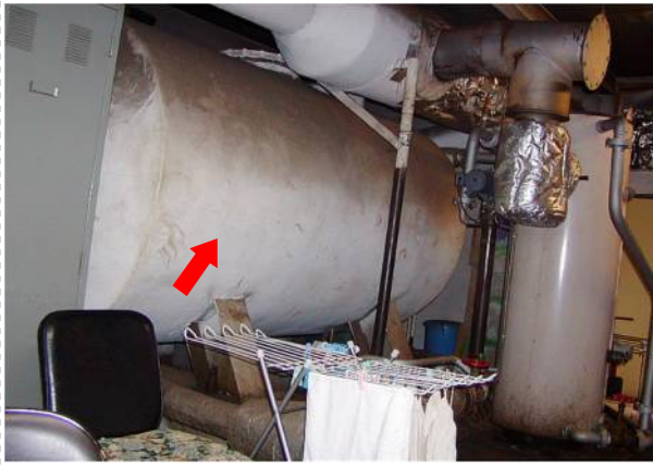
ボイラー本体を覆う石綿含有断熱材
