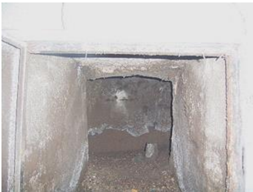
最下部に堆積物(繊維状物質を目視確認)で排水ピットが埋まっている。点検口から煙突まで600mm
