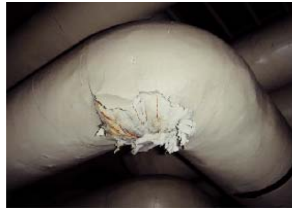
配管エルボの保温材①
