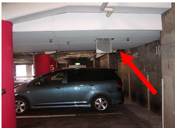
3F駐車場 西側一部天井貼り部(改修履歴有り)、その他はRCスラブ(石綿除去歴あり・飛散防止剤の薬液不明)
