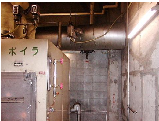
B1Fボイラー室。正面は横引き煙道(断熱材未確認)。左から右にRC部に挿入
