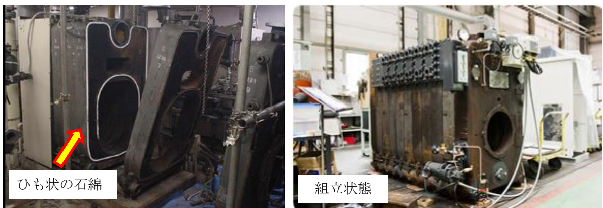
各セクションのジョイント部にはひも状の石綿が使用されている。
