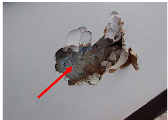
上図矢印位置の腰壁を破壊開放。ウレタン吹付けあり(不採取)
