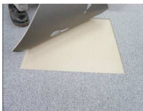
カーペットタイル（下地に残っている）
