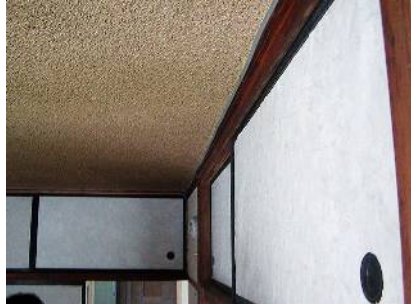
居室天井のバーミキュライト（電着工法）
