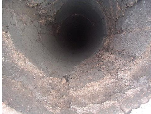
トップより煙突内部の見下ろし撮影。トップから1.5m下まで劣化している。
