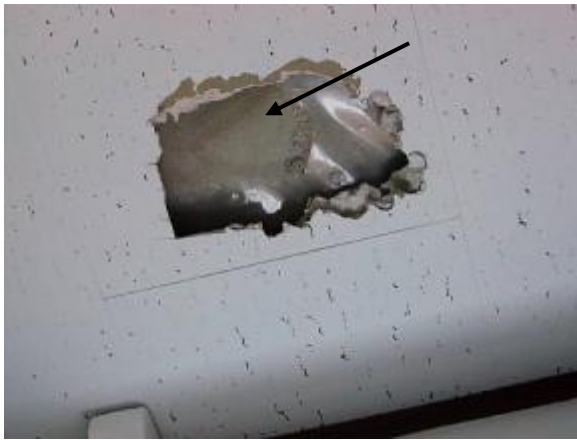
商業ビル 天井石膏ボード裏の吹付けRW ビニールで被膜されている
