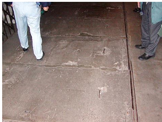
⑳ 同左、隙間あり(将来の除去作業時は注意のこと)
