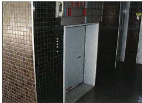
図 2.103 小荷物専用昇降機
