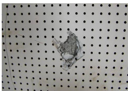
音響調整室など。有孔ケイ酸カルシウム板の内側に吹付け石綿などあり
