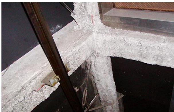
同 見下げ撮影(はり、柱)。吹付けRW(乾式・半乾式)1時間耐火相当。
