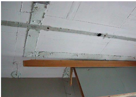
改修が繰り返された部屋。前の間仕切り壁の上部に吹付け石綿が取り残されている。
