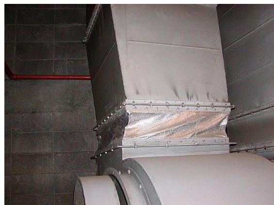
伸縮継ぎ手(不採取)、ダクトパッキン(不採取)
