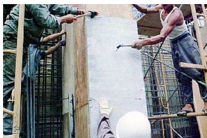
煙突断熱材「角型カポスタック」施工中。コンクリート打込みタイプ
