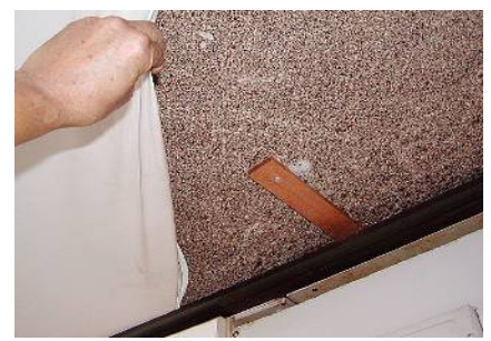
幕天井工法（左側）によるバーミキュライト落下防止措置例
