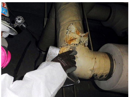
⑮ 機械室A 温水戻り管(表面被幕材の損傷は大)
