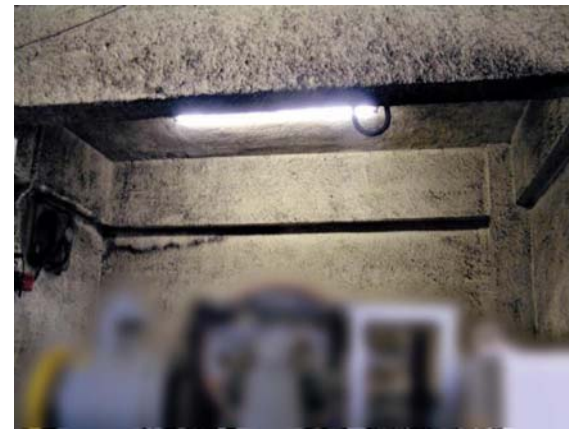
機械室 吸音材
