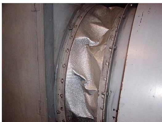
⑮ 空調ダクトの送風側に伸縮継ぎ手(不採取)
