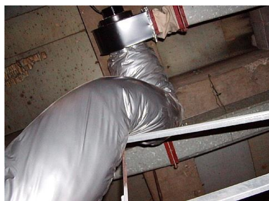
⑥ 同左、グラスウール保温材(不採取)
