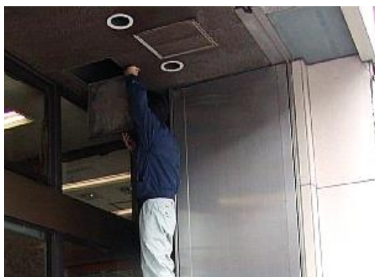
外周部の軒天裏の確認。断熱材なし。玄関ホール内のアルミスパンドレル裏は未調査(依頼者要望)。
