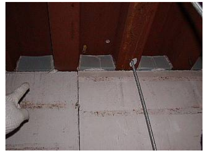
ケイ酸カルシウム板二種によるはりの耐火被覆および同材によるデッキプレートとの間の小間詰め
