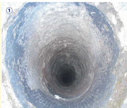
① 表層剥離、毛羽立ち等がある。
