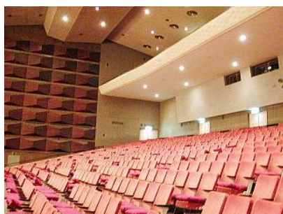
大ホールの天井に接近し観察可能なのは2階席の最後列である
