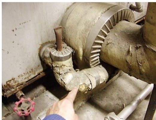
⑯ 機械室A・B共に配管エルボ部の損傷は顕著なものも複数ある
