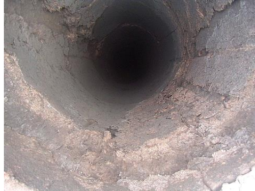
トップより煙突内部の見下ろし撮影。トップから1.5m下まで劣化している。
