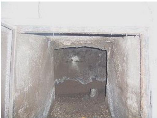
最下部に堆積物(繊維状物質を目視確認)で排水ピットが埋まっている。点検口から煙突まで600mm
