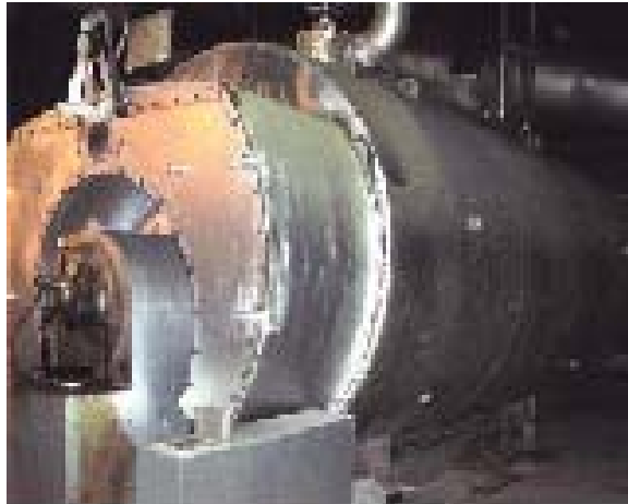
ボイラー の保温材
