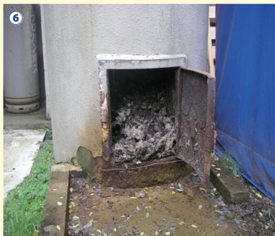
⑥ 点検口に剥落堆積や堆積履歴がある。
