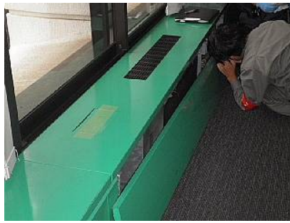
柱きわなどのファンコイルカバーを外しCW裏や層間を見る
