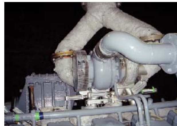
配管エル ボの保温 材②
