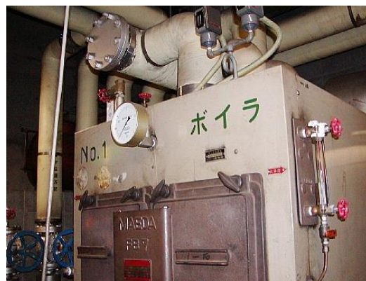
⑩ 1号ボイラー(ボイラー本体内部の断熱材は使用中のため未確認)
