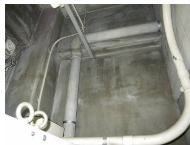
耐火二層管には石綿含有の可能性がある。比較的容易に発見が可能である
