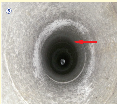
⑤ 一見良好だが、横引き煙道の排気口接続部分（黒色部）に脱落がある。
