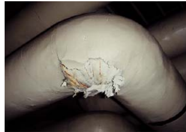
配管エル ボの保温 材①
