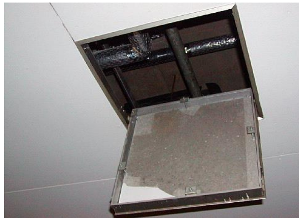
同左 点検口開放(矢印部)、石綿除去後に設備改修され、その配管を隠すために天井を貼ったものと思われる
