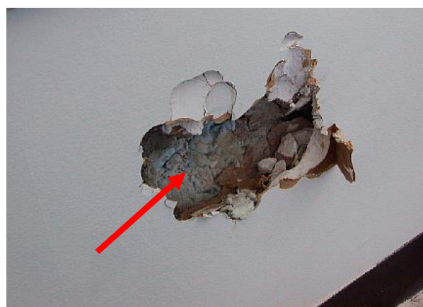
上図矢印位置の腰壁を破壊開放。ウレタン吹付けあり(不採取)
