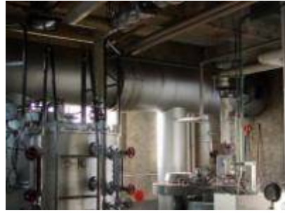
②ボイラー室雰囲気撮影
