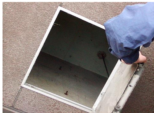
同左。軒天井裏に断熱材はナシ。軒天井板は石綿セメント板下地、ボンタイル調の塗装(不採取)。
