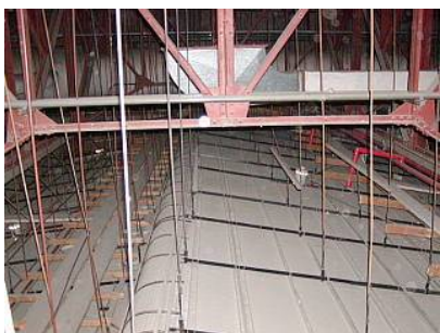
客席の天井裏。左に歩廊、トラス状の大梁には吹付け石綿などあり
