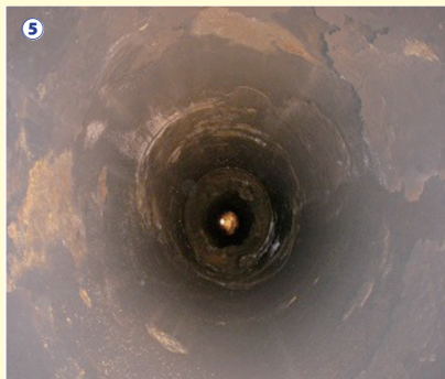
⑤ 下地からの全断熱材脱落がある。
