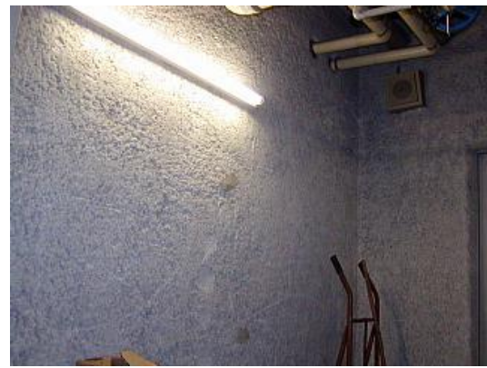
(やや劣化) 全体的な状態はよいが、人為的な損傷が多面にある。
