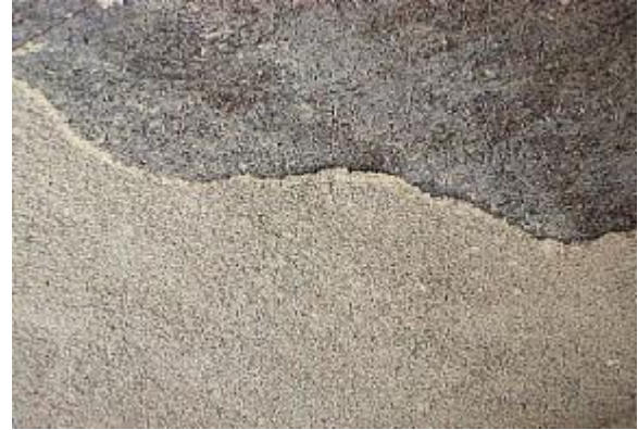
木毛セメント板（上）下地の浮いた吹付け石綿（下）の界面はく離
