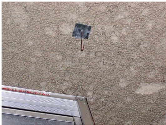
(劣化) 天井面全域に多数の損傷があり、一部では脱落し下地が見えている。
