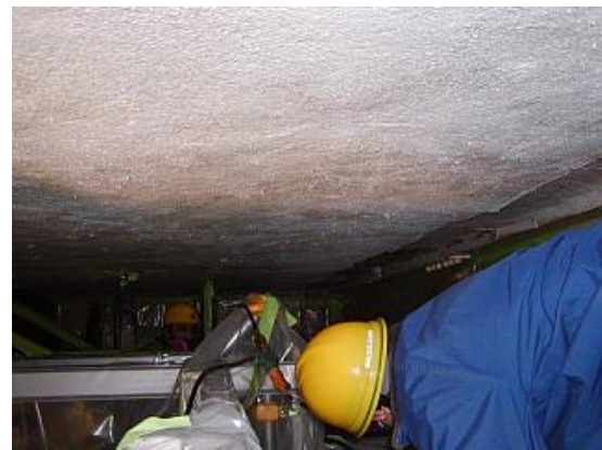
(やや劣化) ある特定のスパンだけ、広範囲に擦過傷がある。
