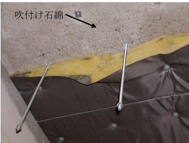
製本・印刷工場感光室天井。吹付け石綿の上にグラスウール+黒寒冷紗張仕上げ
