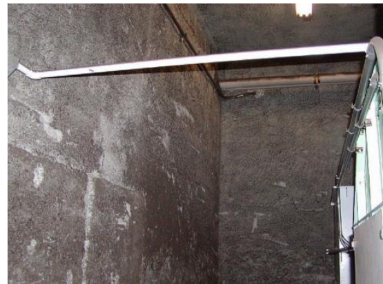
(やや劣化) 複数面に擦過傷が見られ、また下地の段違いが出現してきている。
