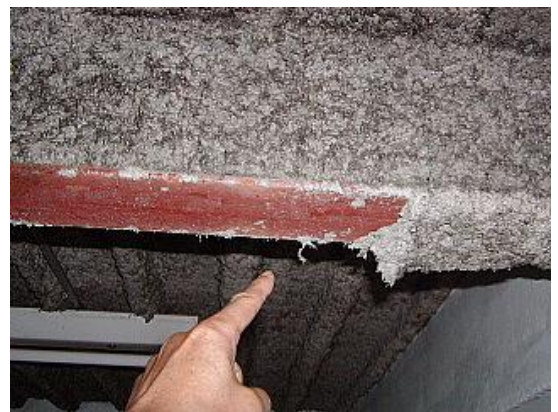
(劣化) 吹き放し工法であり、セメントスラリーもなく脱落箇所がある。
