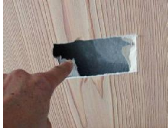
共同住宅最上階 天井ボード裏の吹付けRW
