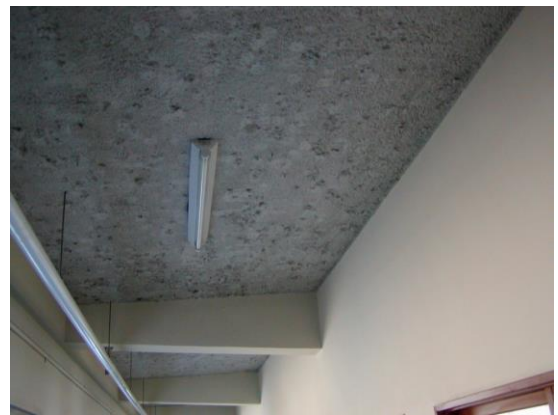
(劣化) 多くのスパンで損傷があり、一部では界面にまで達する傷が多くある。
