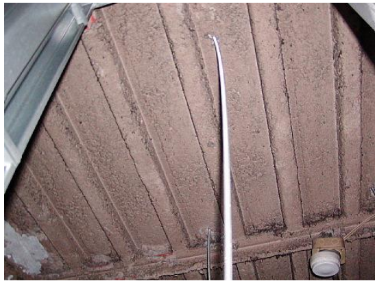
(やや劣化) デッキプレート 表面がささくれている。
