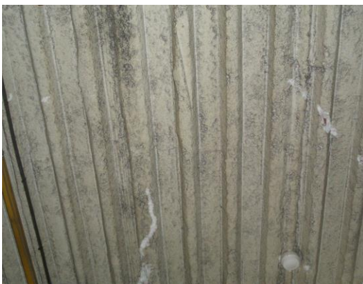
(やや劣化) 引っ掻き傷ではなく、原因不明の素材の筋状の色違いが生じている。
