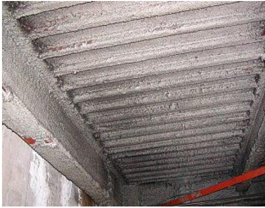
(劣化) 全面的にボロボロ（ささくれ、逸失など）の状態である。
