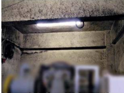
機械室吸音材
