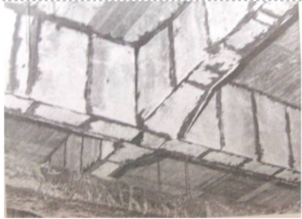
図 2.69 鉄骨はりの石綿耐火被覆板
