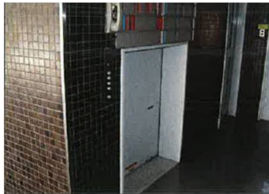
図 2.103 小荷物専用昇降機
