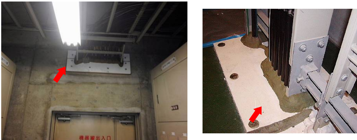
図 2.99 壁や床のケーブル貫通部の処理(けい酸カルシウム板第2種)
