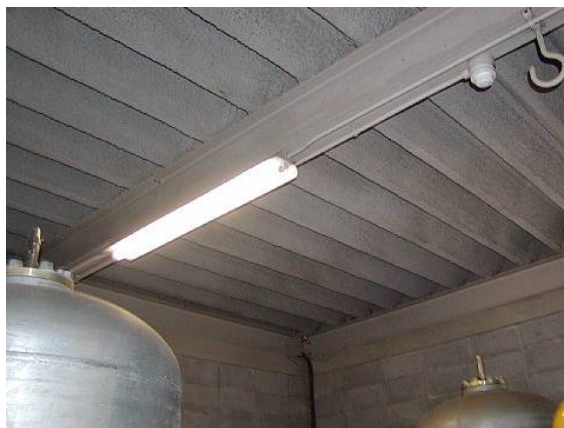
図 2.73 不燃材料の吹付けロックウールの使用箇所例 （折板屋根の裏面の石綿含有ロックウール）
