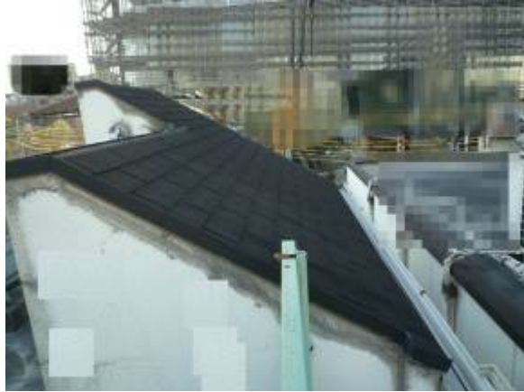
低層ビル屋上の階段室屋根の化粧スレート（アスベストコロニアル）
